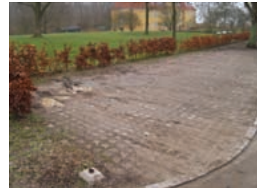
Øverst: For at græsarmering skal fungere, er det vigtigt at der er vækstrum nok til græsset. Det er ikke tilfældet når disse græsarmeringssten lægges på et komprimeret stabiltgrus underlag.
